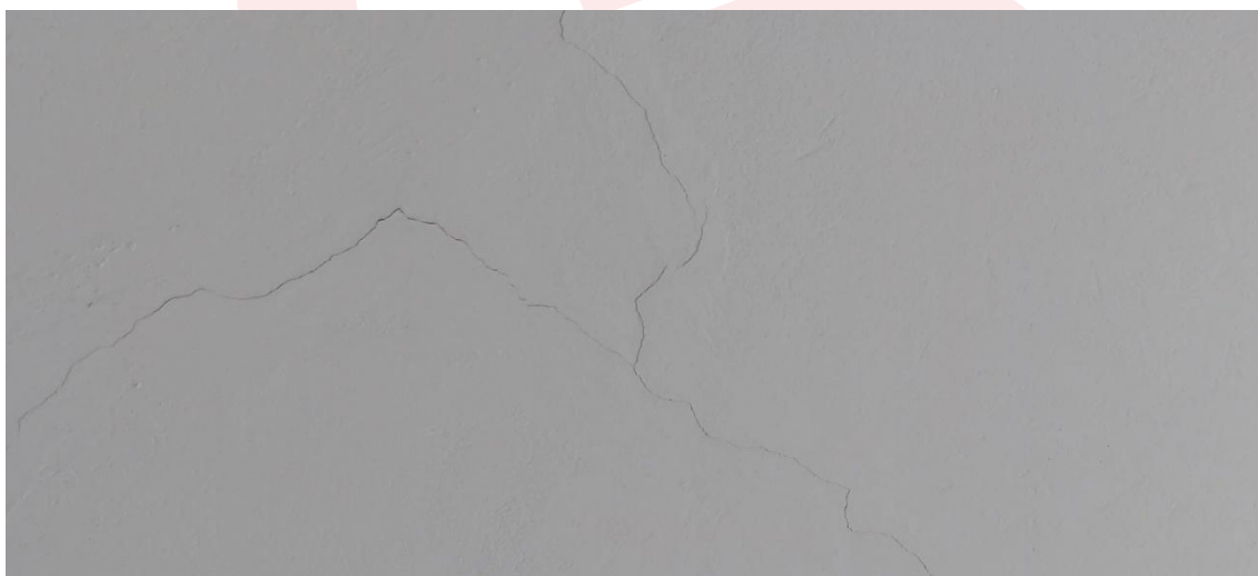
Figura 15 - Fissura no Teto
