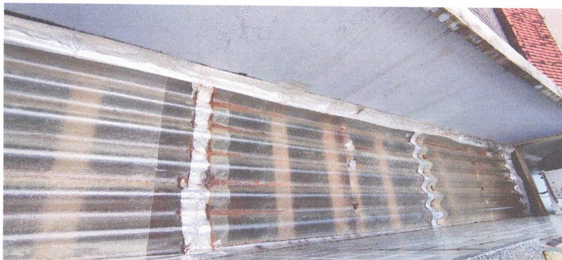
Figura 16 - Telhas plásticas transparentes
